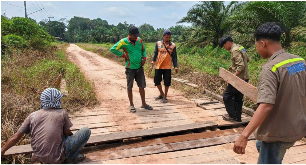
Gambar 1 Observasi Awal Tim Teknik Sipil terhadap Jembatan Kayu Eksisting di Kecamatan Anggana
