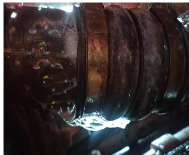
Gambar 9. kebocoran dalam saluran pipa
